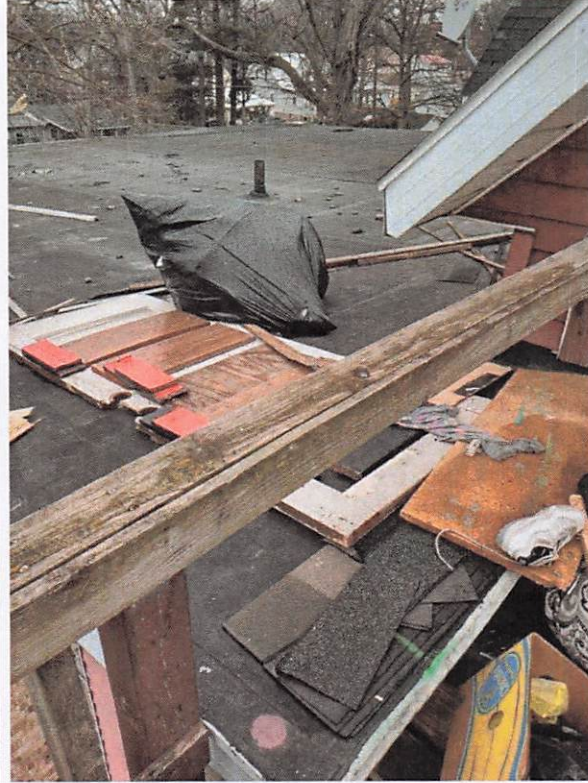
Exterior trash, junk, debris.
