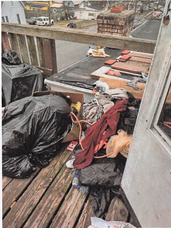
Exterior trash, junk, debris.
